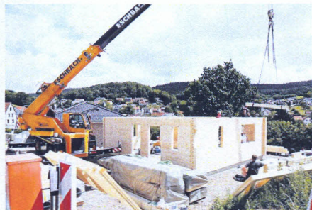
Zwischen dem oberen und diesem Bild liegt nur eine Woche. Mittlerweile sind schon Fenster eingebaut und die Dachdämmung angebracht.
